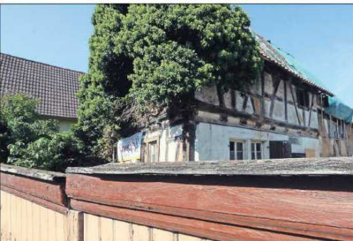
Das Fachwerkhaus aus dem 17. Jahrhundert in der Theodor-Heuss-Straße 51 dümmert seit langem vor sich hin. Jetzt will sich der Verein „Projekt 51“ um die Sanierung und künftige Nutzung kümmern.
